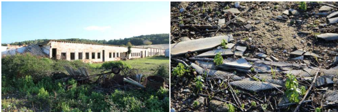
Imatge 51. Presència de residus i restes d'amiant
