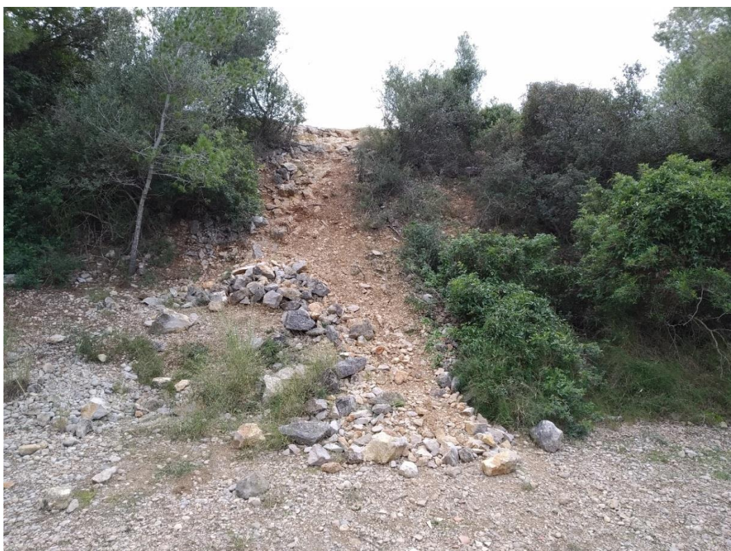
Fotografia 3. Exterior de la corba peraltada W, amb la presència d'algun tram esllavissat.
