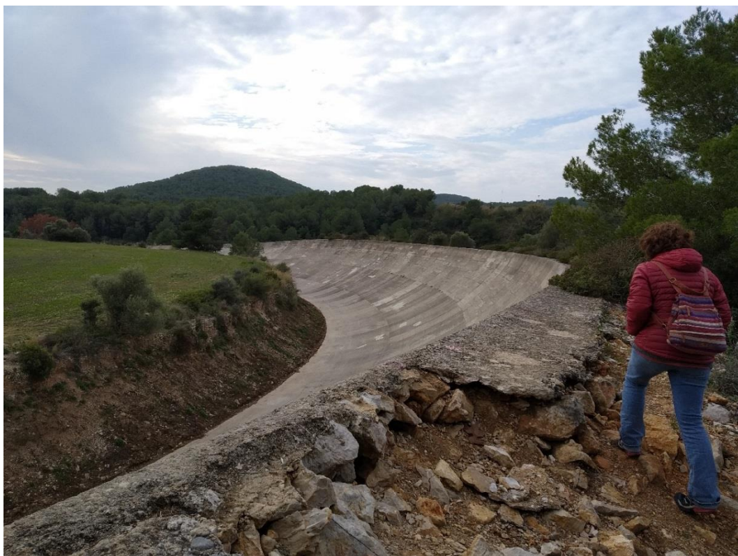
Fotografia 4. Exterior de la corba peraltada W, amb algun tram esllavissat.
