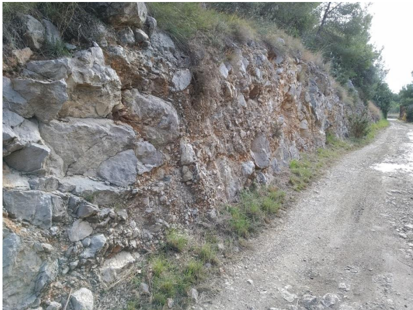
Fig. 26. Talús sobre materials Cretàcics a l'accés a l'àmbit per la carretera C-246a
